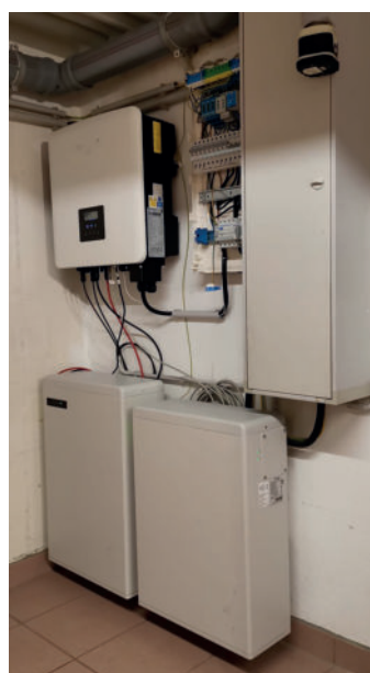
Batteriespeicher im Keller.
